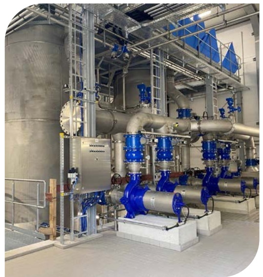
Abb. 2: Die neue SEC-Anlage im Wasserwerk Osthofen zur Enthärtung des Trinkwassers
